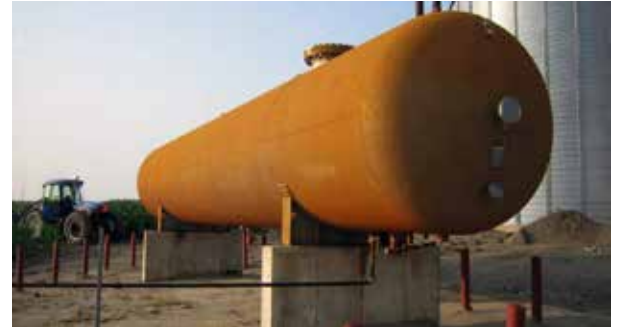
Recipiente afectado por corrosión exterior
